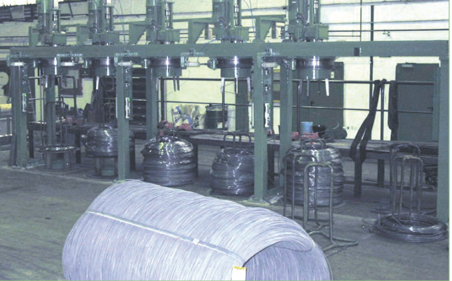
Phosphatüberzüge auf Metalloberflächen mit Staku-Ephos-Inline-Anlagen Bild: Staku-Anlagenbau
